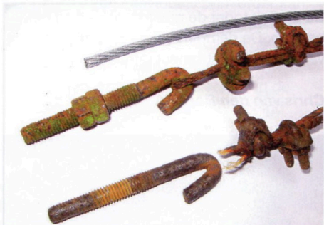
Afb. 21 Ondanks dat de kabel een scherpe knik in de haak maakte, is het jaren goed gegaan. Bovenaan de foto ter vergelijking de nieuwe kabel.
